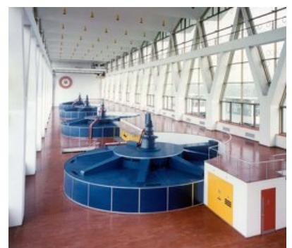
© Kraftwerk Birsfelden AG
