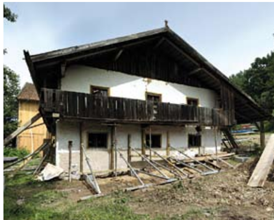
← 04 Das Bayerwaldhaus im Bauzustand: Die Außenwände der Stube werden abgestützt, da sie beim Betonieren des neuen Wohnraums als verlorene Schalung dienen.
