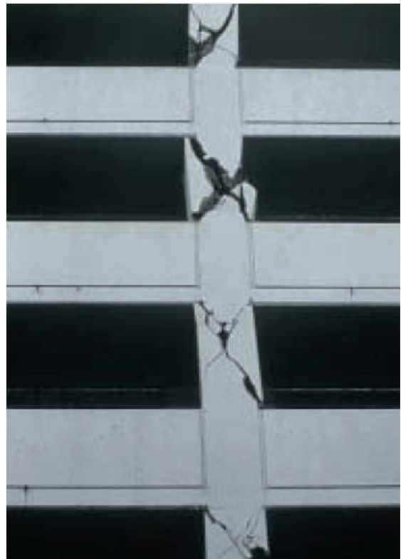
Abb. 2-12: Versagen von Stahlbetonstützen nach einem Erdbeben durch die zusätzlichen Beanspruchungen einer massiven Brüstung
