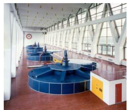
© Kraftwerk Birsfelden AG
