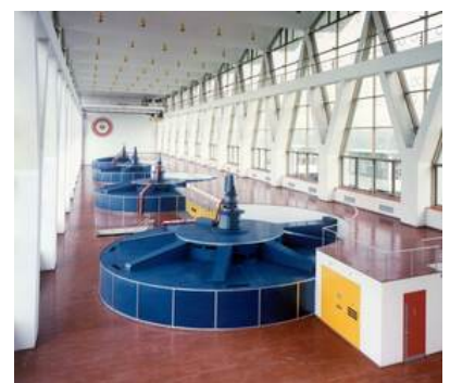
© Kraftwerk Birsfelden AG
